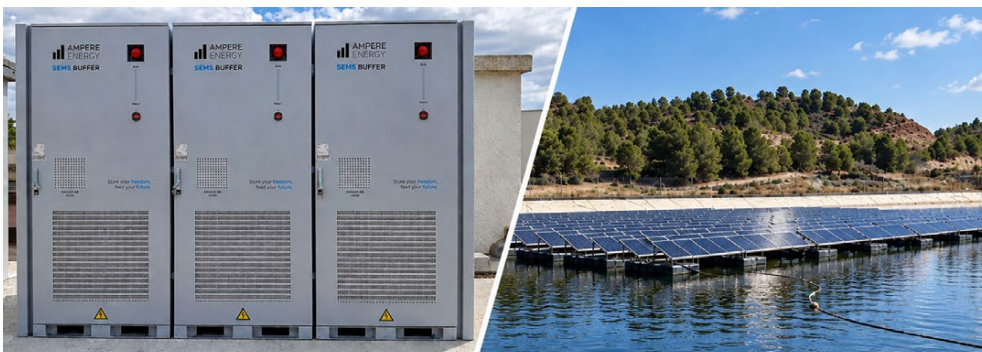
Instalación SEMS Buffer LC 375 kW / 783 kWh en comunidad de regantes con instalación PV flotante de 100 kWn.
