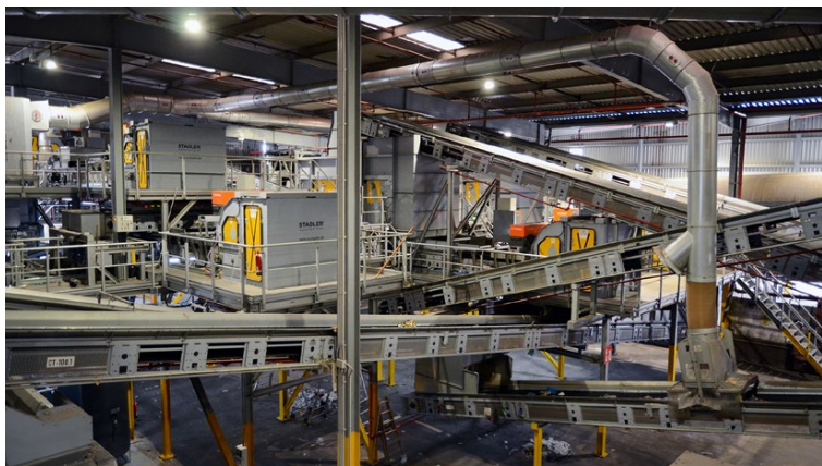
Proceso de tratamiento del Complejo Ambiental de Miramundo (Cádiz)
