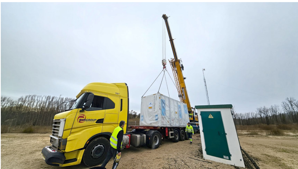
Descarga de un sistema de 2MWh en un proyecto de Green Power
