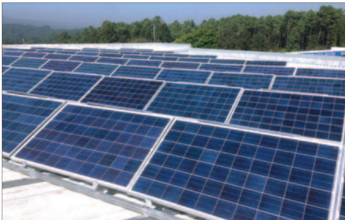
Instalación de Autoconsumo Fotovoltaico
