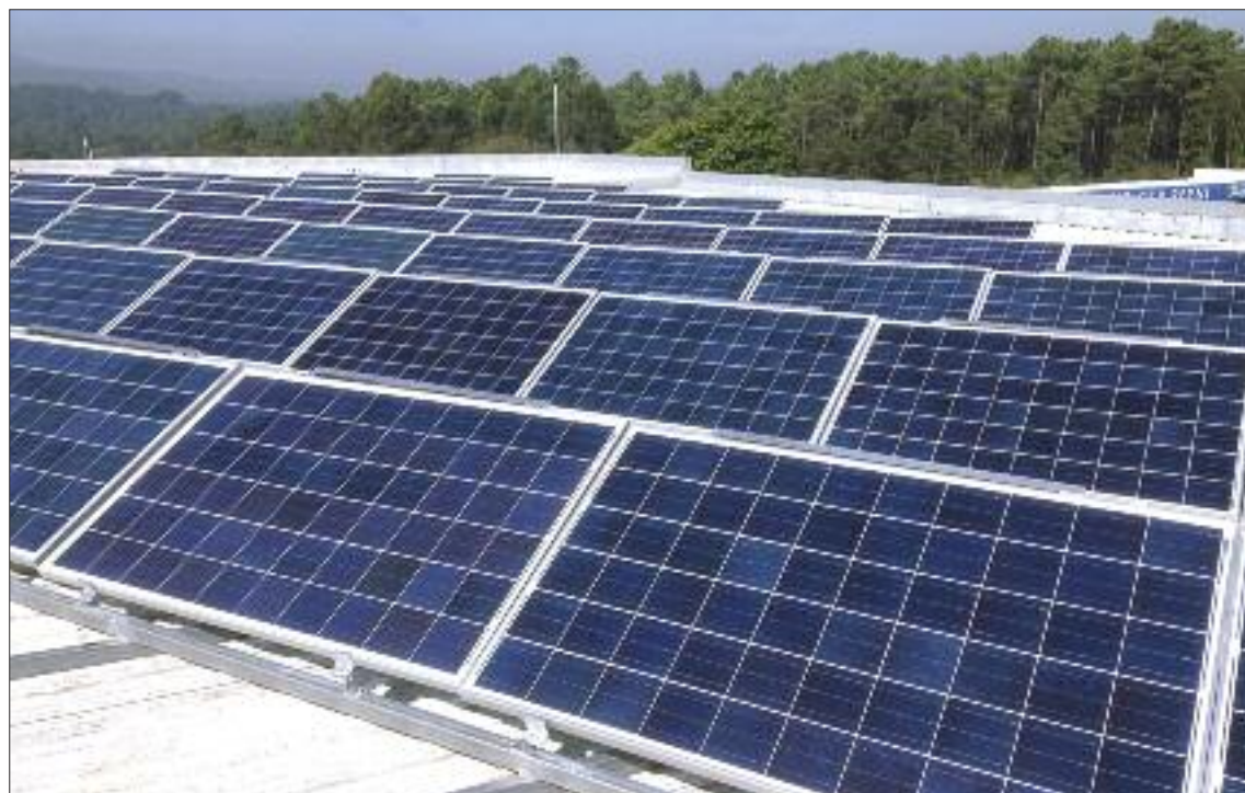
Instalación de Autoconsumo Fotovoltaico
